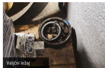
Notranjost ohišja kompresorja
