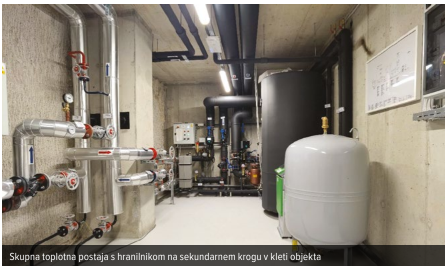
Pogled v »drobovje« stanovanjske toplotne postaje
