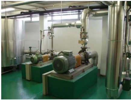
Slika 1: Tehnološki del postrojenja Volukal
